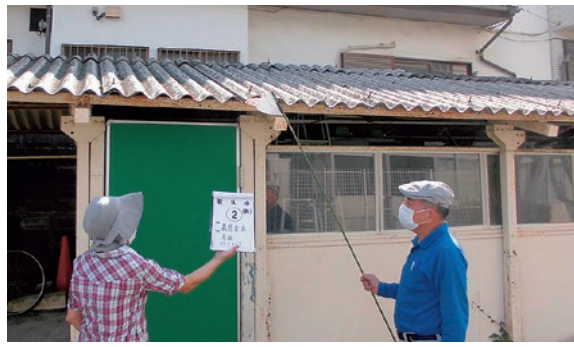
アスベスト含有建材の波型スレートを指摘する調査者
