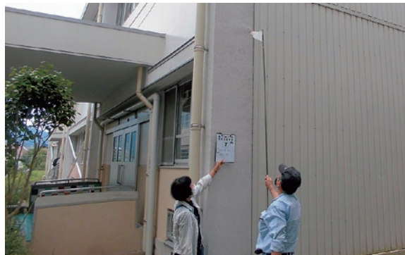
壁面の亀裂を指摘する調査者
